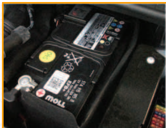
12V-Batterie im Motorraum
